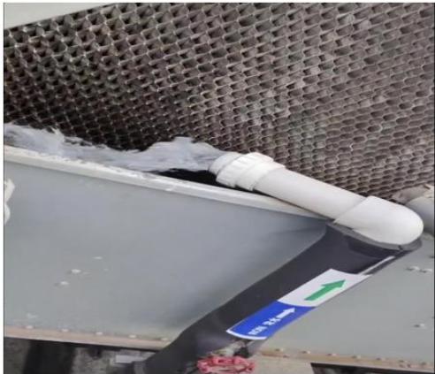
回收水供应至冷却水塔
