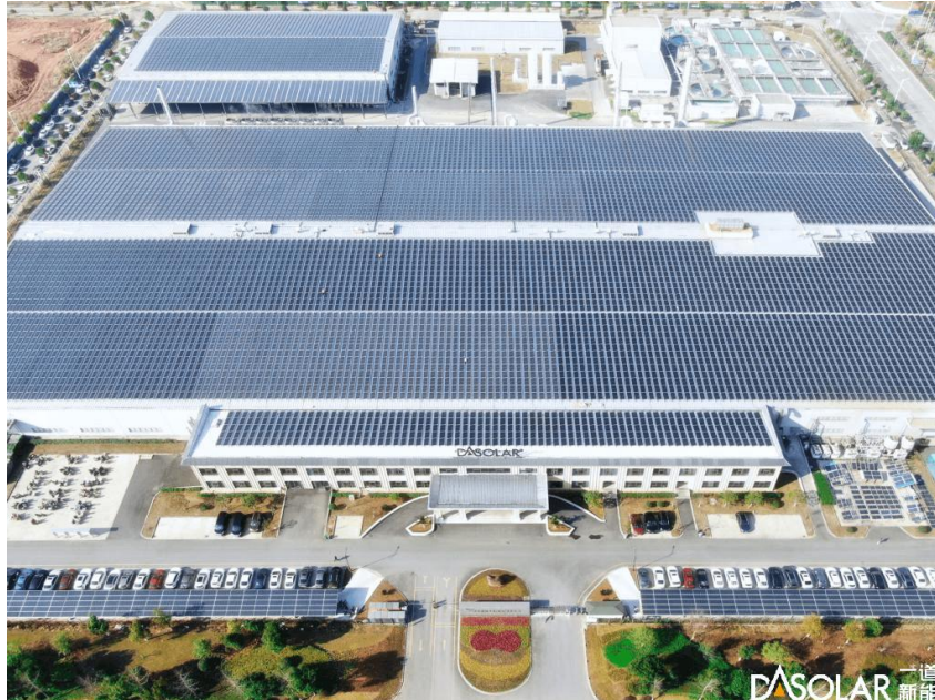
衢州基地屋顶光伏装置
